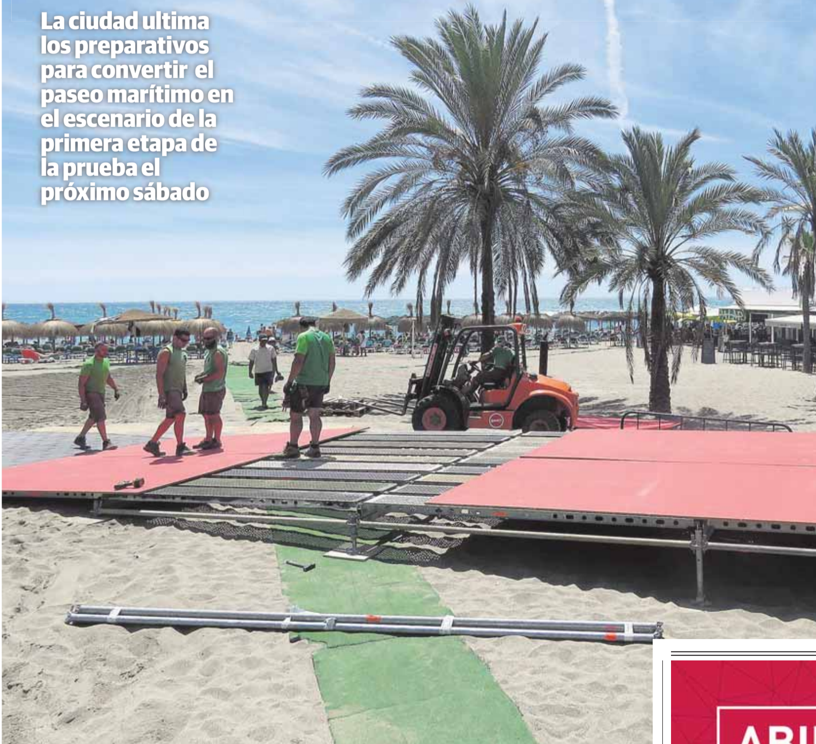
Durante la jornada de ayer se empezó la instalación de la rampa hacia la playa donde se ubicará la meta. :: J-LANZA
