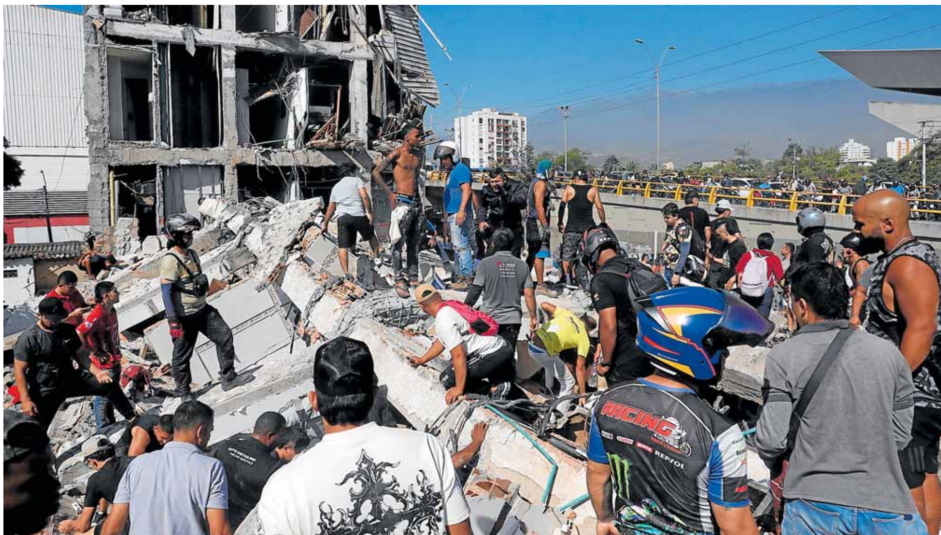
Personas caminan sobre los escombros de un edificio colapsado este lunes, en Cali (Colombia). EFE
